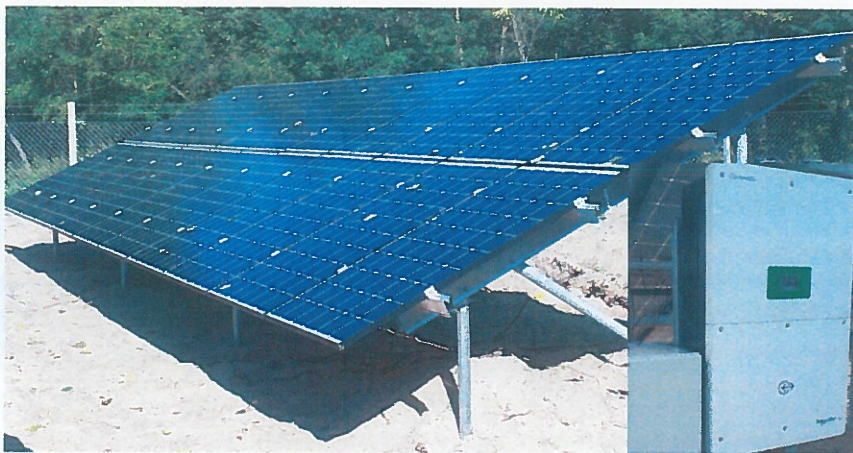
1. sz. kép – Zsana Fotovillamos Naperőmű egy sztringje és invertere
